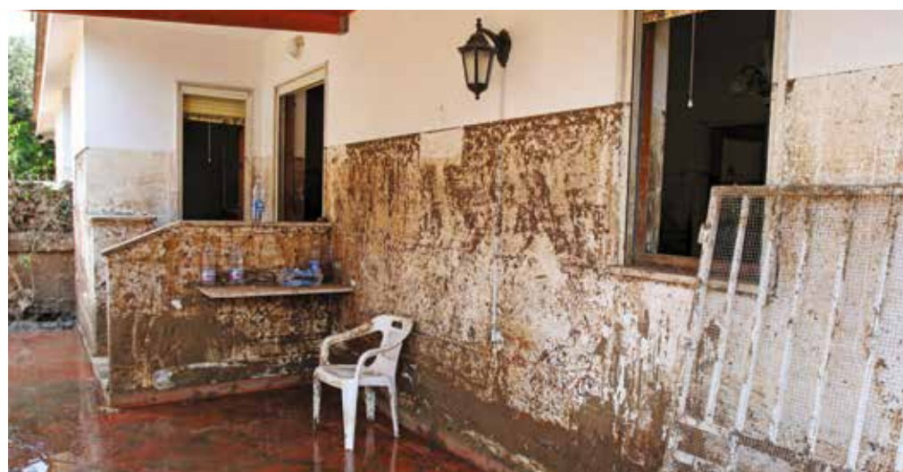
Foto 59. Vibo Valentia, 2006. Danni a un'abitazione causati da un'alluvione.
