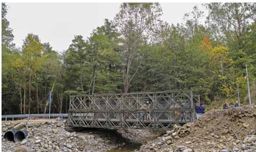
Foto 98, 99. Amatrice, 2016. Installazione di un ponte bailey in località Retrosi per il ripristino della viabilità stradale.
