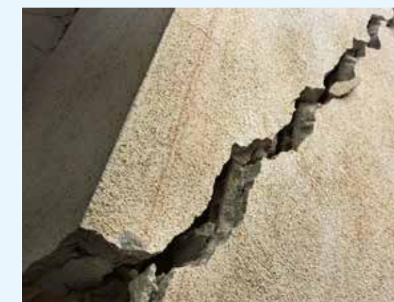
Foto 10. L'Aquila, 2009. Particolare di edificio lesionato dal terremoto del 6 aprile.
